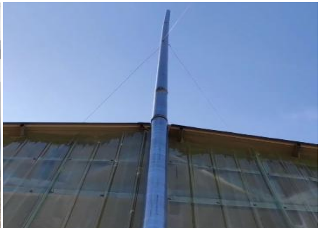
堆肥区排气筒
