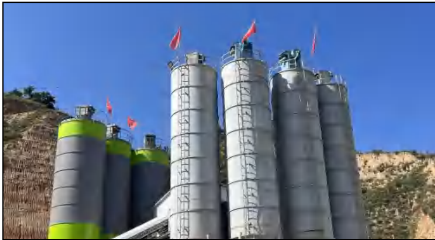
筒仓仓顶除尘器
