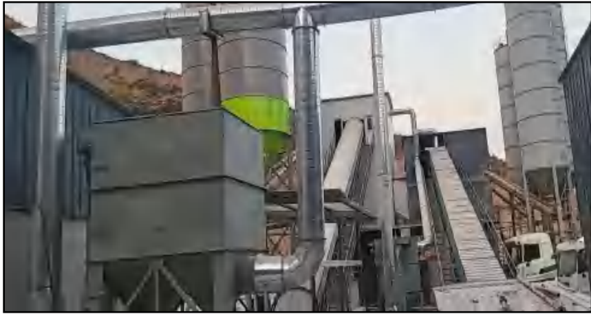
上料、搅拌工序除尘器
