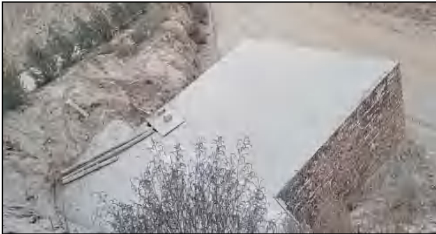
初期雨水收集池
